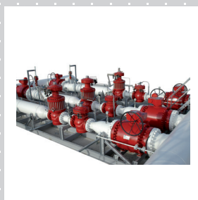
Station de réduction et de comptage
