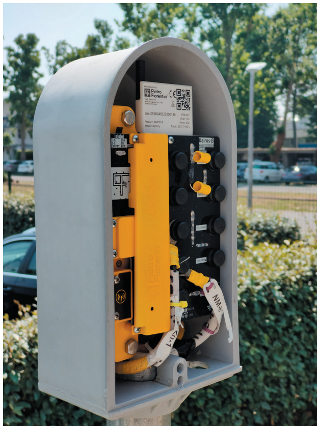
Abbildung 4 Kairos, vor Ort installiert
