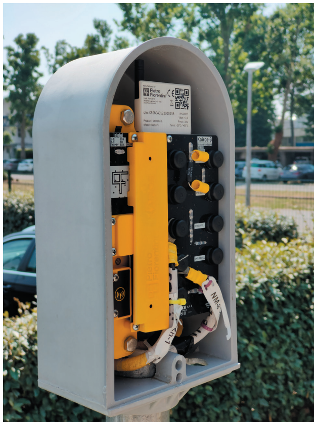
Figure 4 Kairos installé sur le terrain
