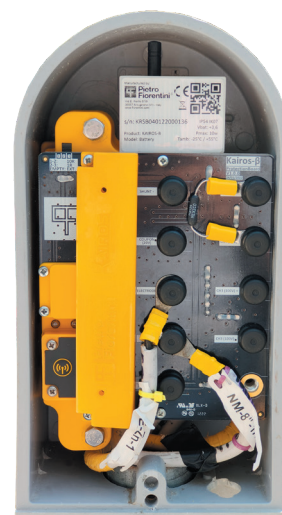
Figura 3 Instalación de Kairos
